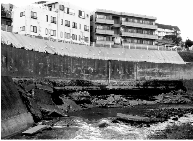
上岩崎公園下流の右岸 護岸が崩落
